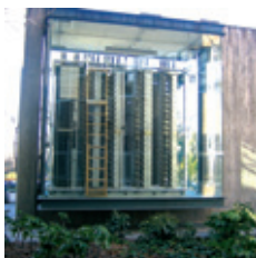
Centralita telefónica situada a la entrada de la Escuela Técnica de Telecomunicación.
