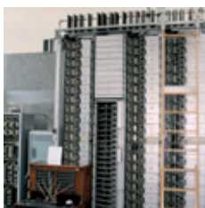
Centralitas telefónicas (izquierda) y equipos de radar (derecha) situados a la entrada del Museo.
